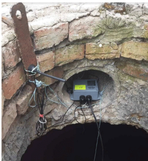
Рис. 1. Узел контроля уровня воды в резервуаре на базе Zulu-датчика (логгера) PROMODEM
